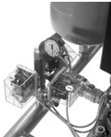
Рис. 119 Реле давления, установленные на коллекторе
